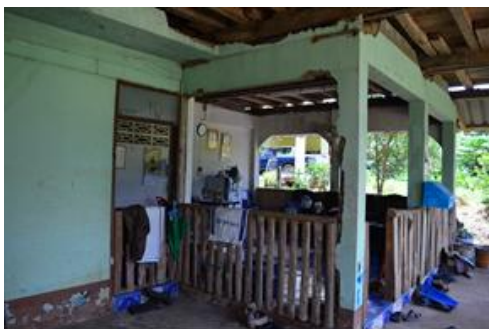
ภาพที่ 1 สภาพบ้านที่เสียหายจากน้ำป่าไหล ในลำน้ำแม่ปาน
